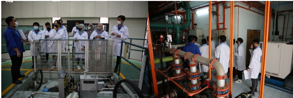
Penerangan berkaitan SSC di pelantar reaktor (kiri) dan Sistem Penyejukan Primer (kanan).
